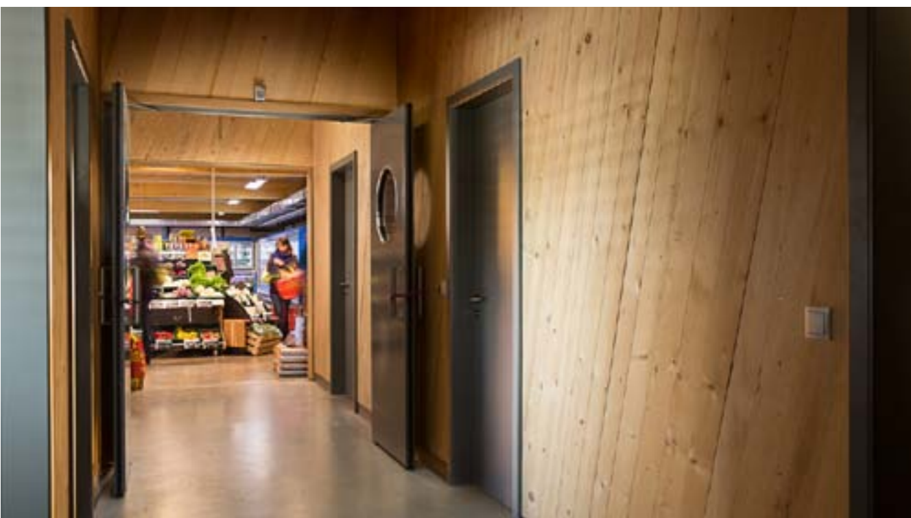
Povrchy stěn a stropů byly naolejovány organickými oleji
