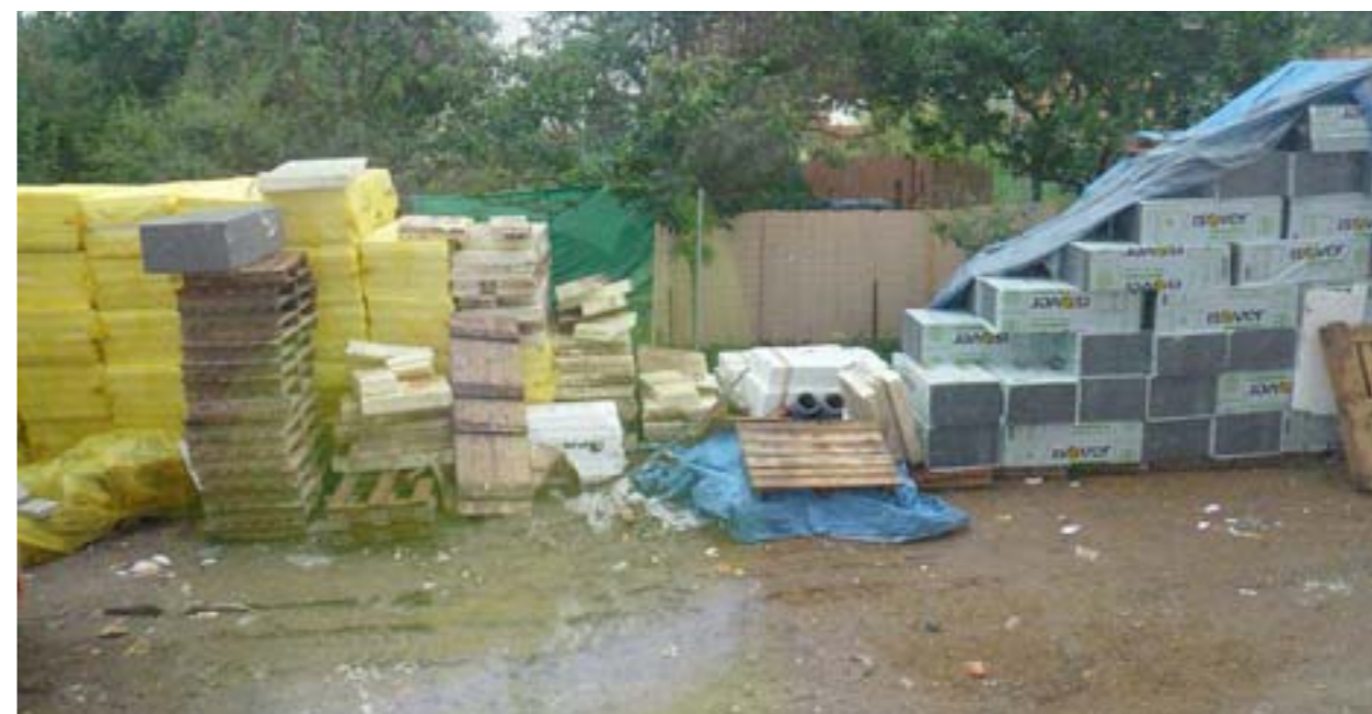
Případ čtvrtý – nevhodné skladování tepelné izolace, minerální vlny i šedého fasádního polystyrenu vede k jeho znehodnocení
