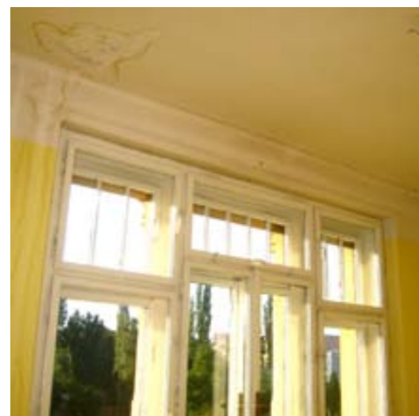
Zatékání okny před opravou (foto: Miroslav Herčík)
