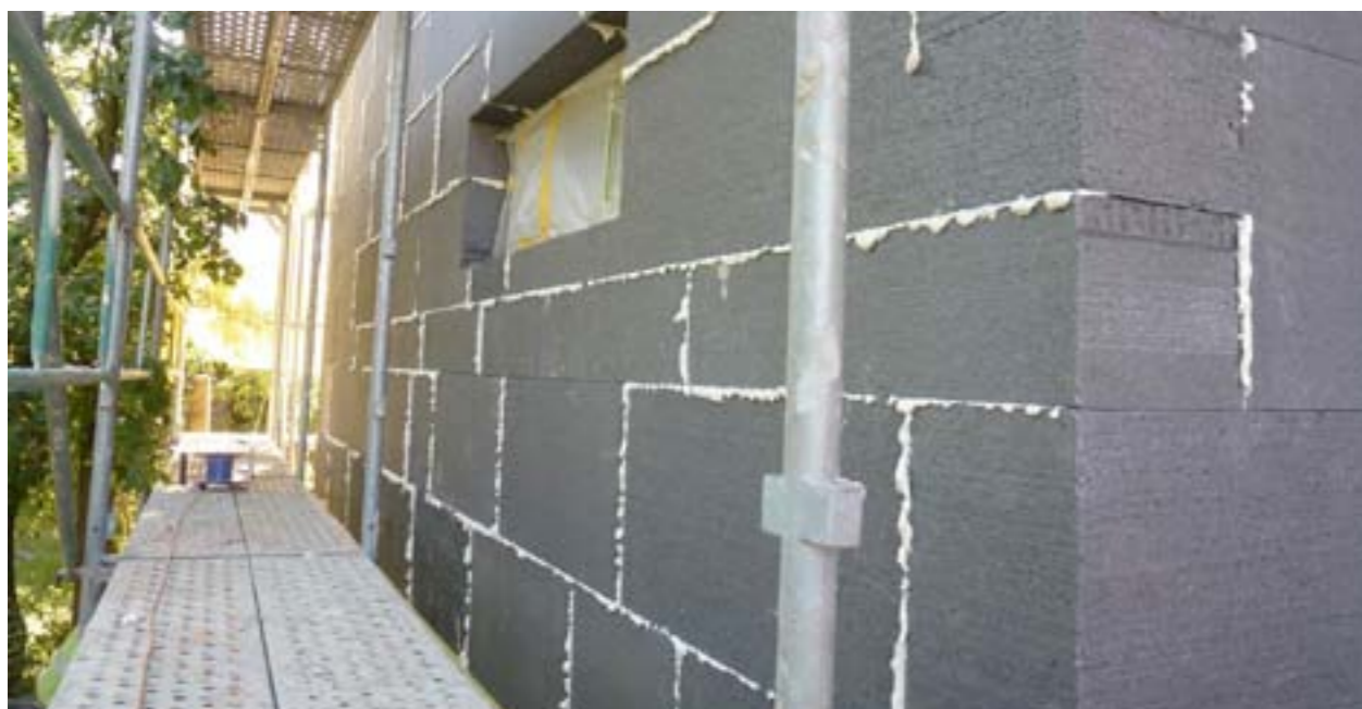
Případ třetí – velmi často se opakující chyba při provádění kontaktního zateplení – široké spáry vytvářejí tepelné mosty a poruchy na fasádě. Vada je neodstranitelná.
