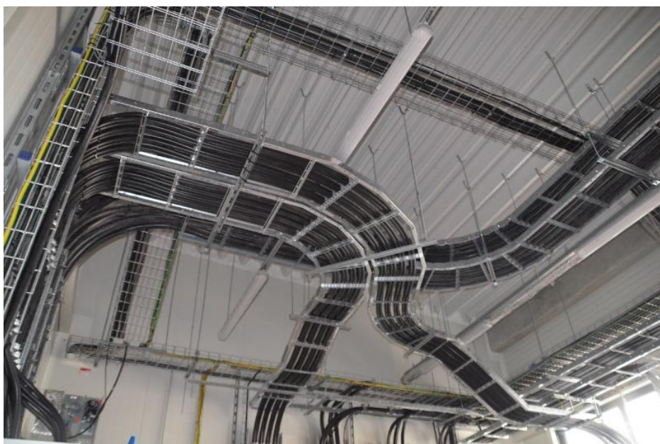
Obr. 6 Příklad zvlášť vysokého zatížení svazky kabelů působícího na jedné vlně
