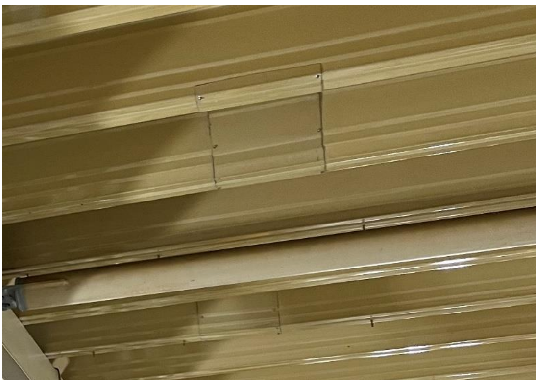
Obr. 10 Prostupy trapézovým plechem zajištěné „záplatou“ o neznámé statické účinnosti
