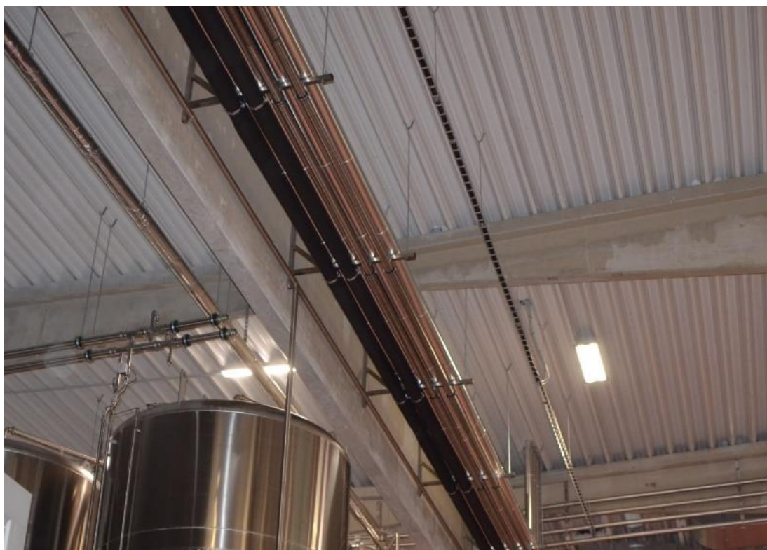
Obr. 7 Příklad zvlášť vysokého zatížení množstvím potrubí působícího na jedné vlně v kombinaci s ukotvením na ŽB průvlak
