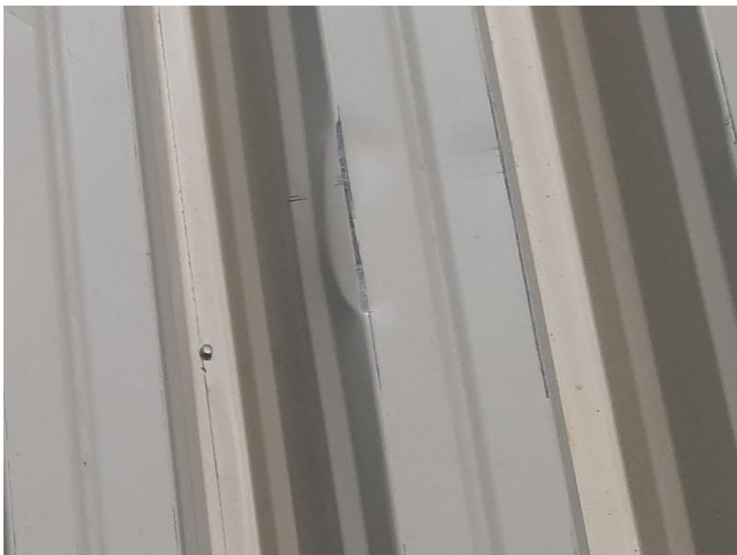
Obr. 12 Zdeformovaná vlna – poškození při montáži
