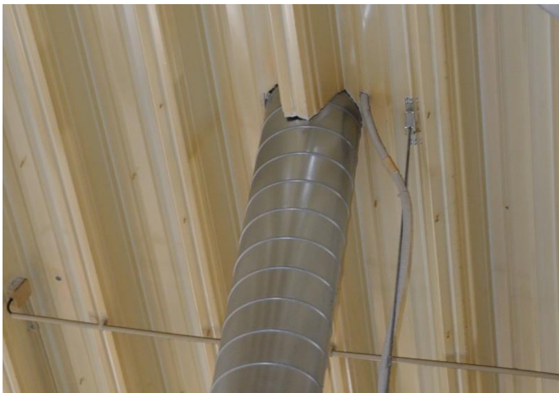
Obr. 8 Nezajištěný prostup trapézovým plechem – přerušená spodní vlna a stojiny trapézového plechu
