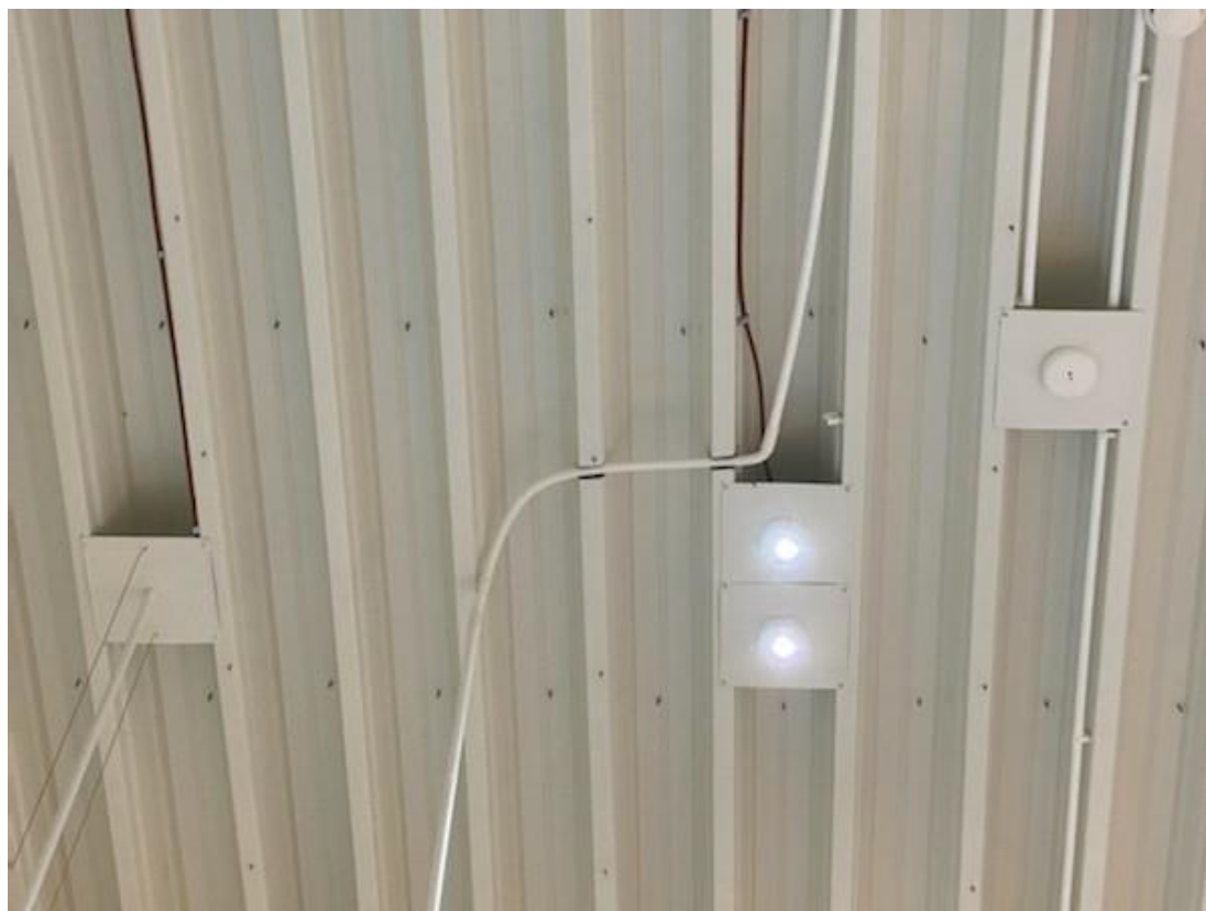
Obr. 13 Poškozená spodní vlna – průchod kabelů
