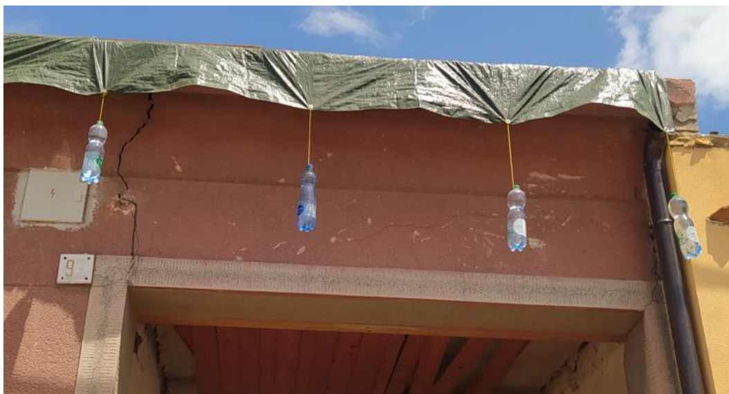
Obr. 18 Trhlina v místě uložení překladu nad vraty
