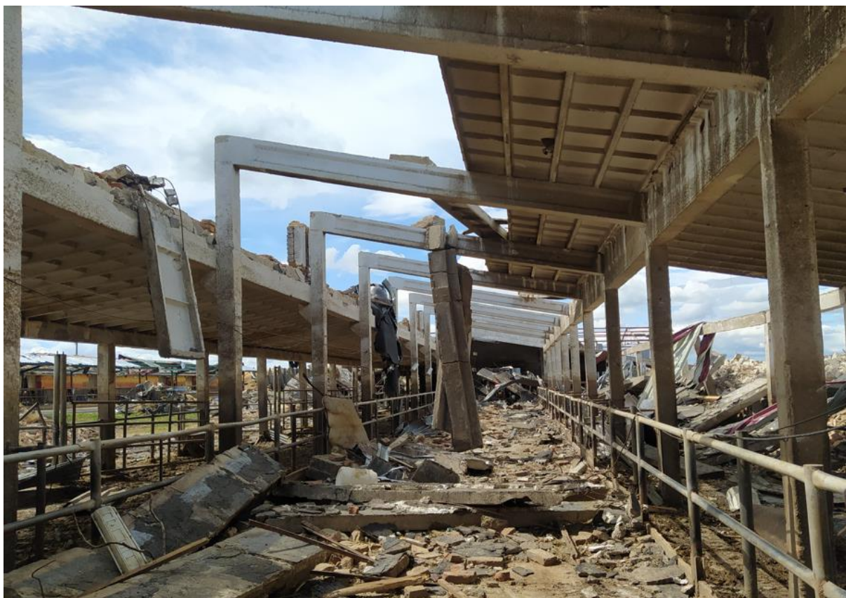
Obr. 39 Destrukce železobetonové konstrukce
