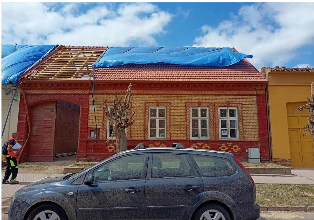
Obr. 8 Škody způsobené tornádem – narušení krytiny
