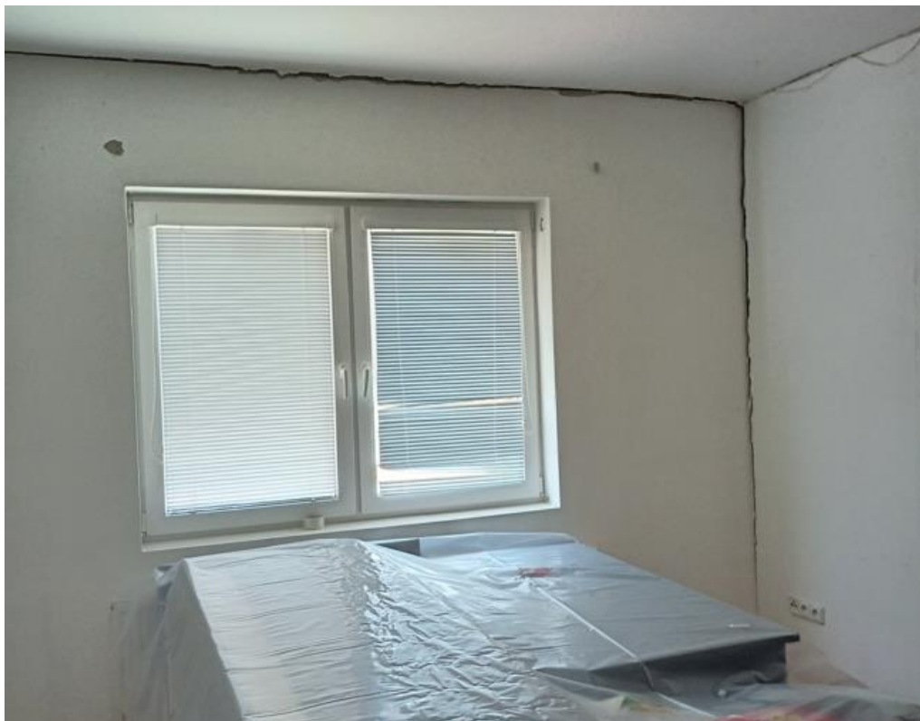
Obr. 35 Naklonění nosného zdiva obvodové stěny
