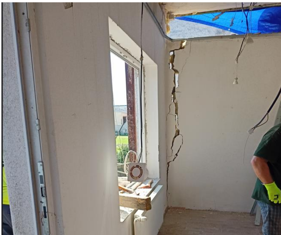
Obr. 37 Naklonění nosného zdiva obvodové stěny
