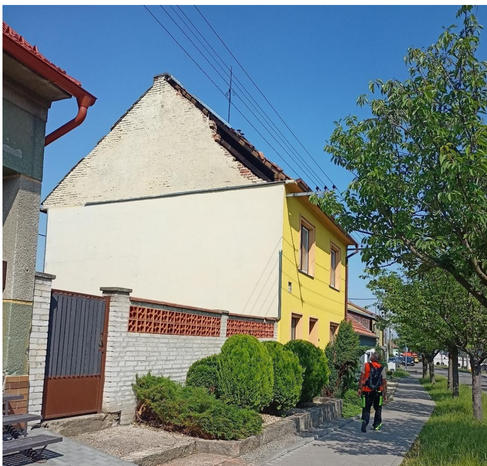
Obr. 9 Škody způsobené tornádem – narušení krytiny a části štítového zdiva
