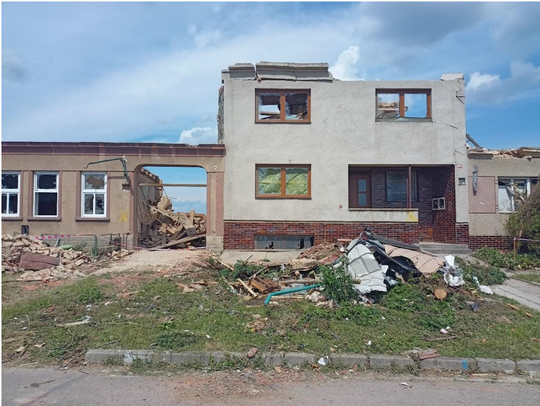
Obr. 10 Škody způsobené tornádem – narušení konstrukce střechy a zdiva nejvyššího podlaží
