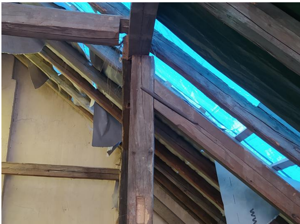
Obr. 14 Uvolnění styku prvků krovu
