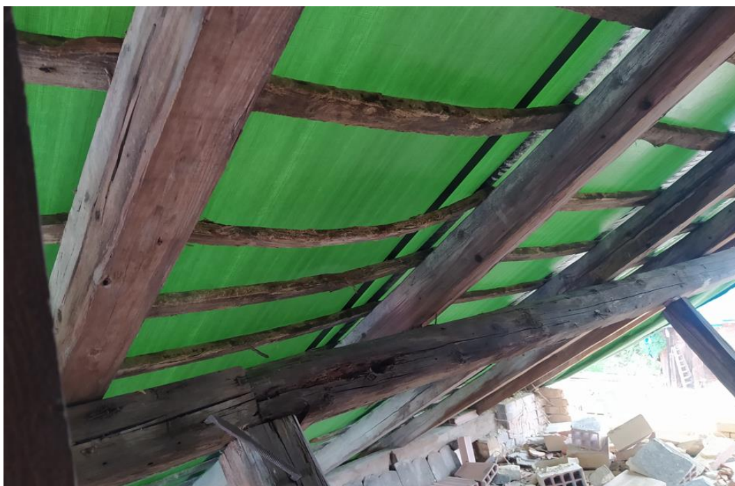
Obr. 19 Degradovaná konstrukce krovu
