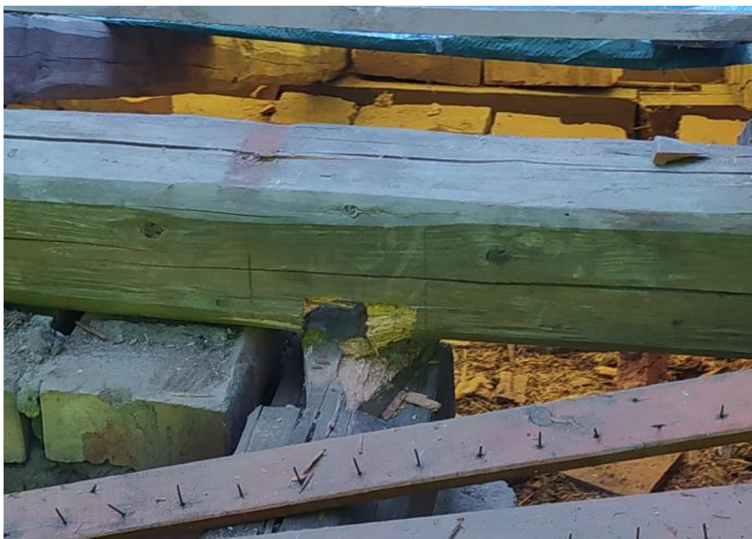
Obr. 16 Uvolnění vazného trámu ve styku s pozednicí (rybinový kámp)
