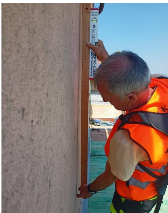
Obr. 36 Naklonění nosného zdiva obvodové stěny
