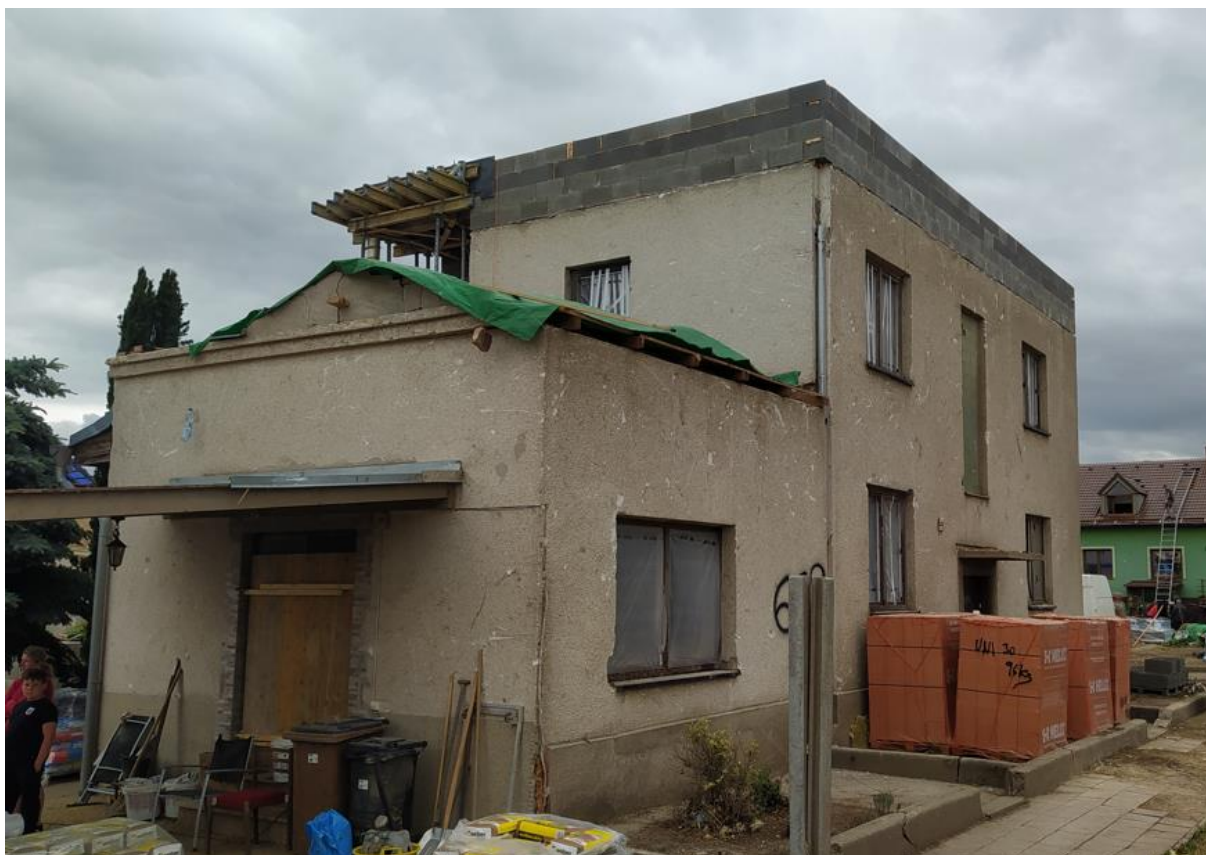
Obr. 26 Stav RD cca tři dny po tornádu – snaha o provedení nepovolené nástavby. Následoval zásah SÚ a snížení nadezdívky
