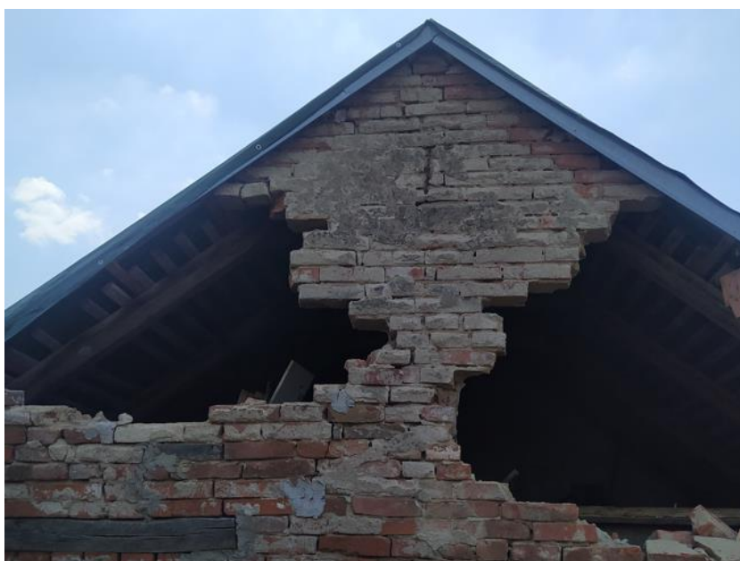
Obr. 13 Uvolněné štítové zdivo
