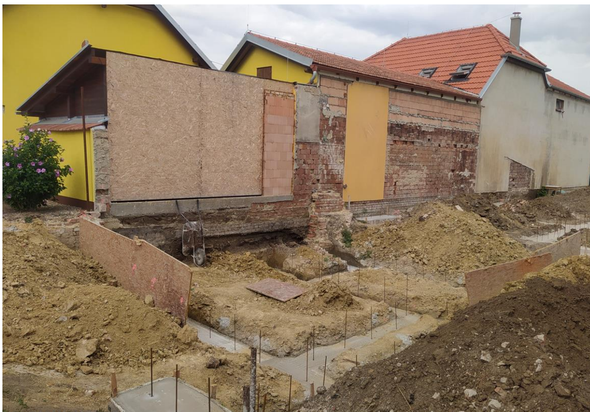
Obr. 30 Obnažení a podkopání základu sousední nemovitosti
