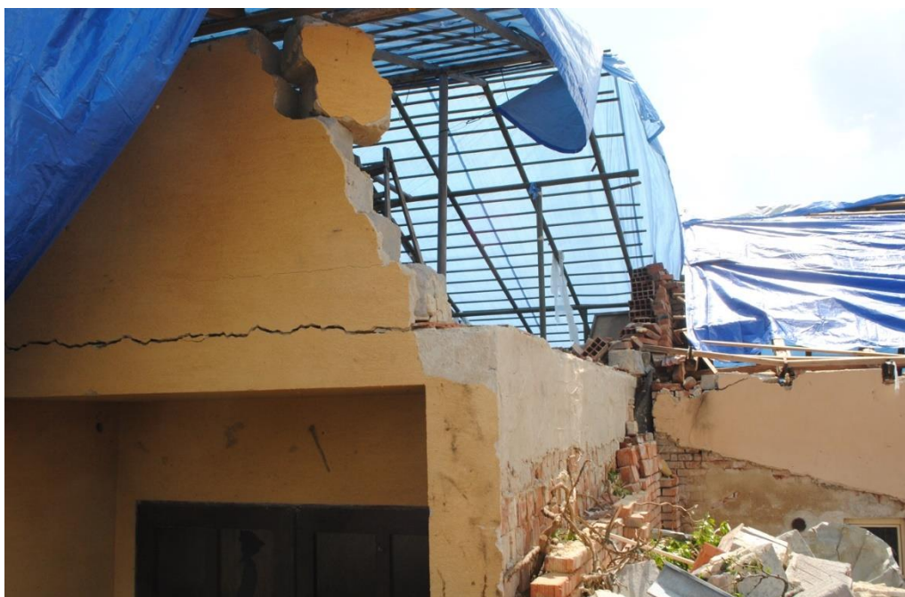
Obr. 32 Poruchy ve zdivu nad úrovní stropu nad 1.NP
