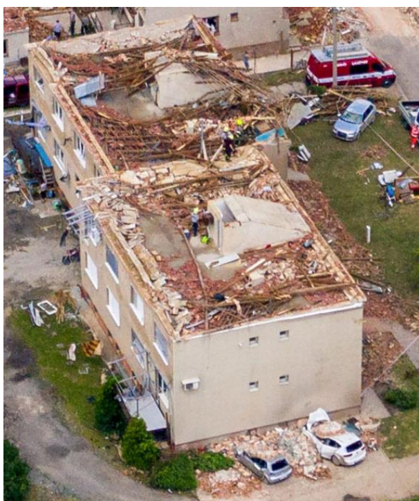
Obr. 6 Škody způsobené pádem konstrukcí
