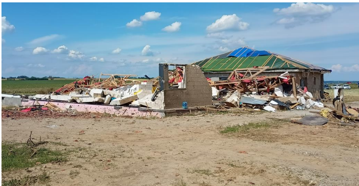
Obr. 12 Škody způsobené tornádem – úplná destrukce objektu
