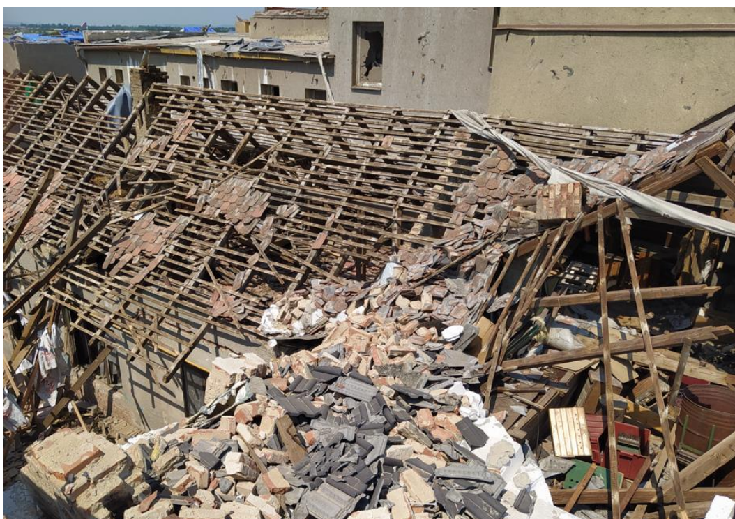
Obr. 17 Přetížení stropní konstrukce sutí ze zřícených částí objektu
