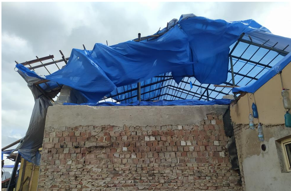
Obr. 31 Pohled na zborcené štítové zdivo a na původní ocelový krov RD
