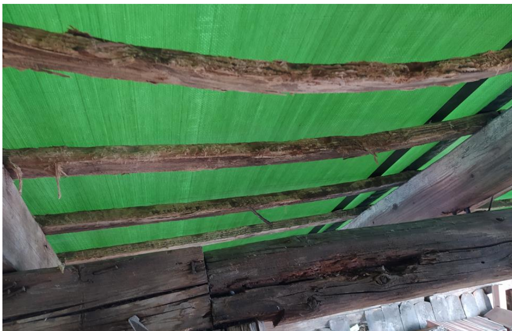
Obr. 20 Degradovaná konstrukce krovu
