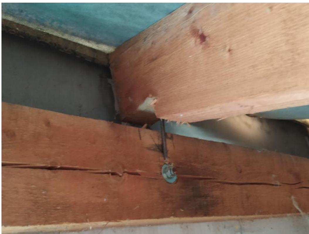
Obr. 15 Uvolnění a posunutí krokve v místě uložení na vaznici
