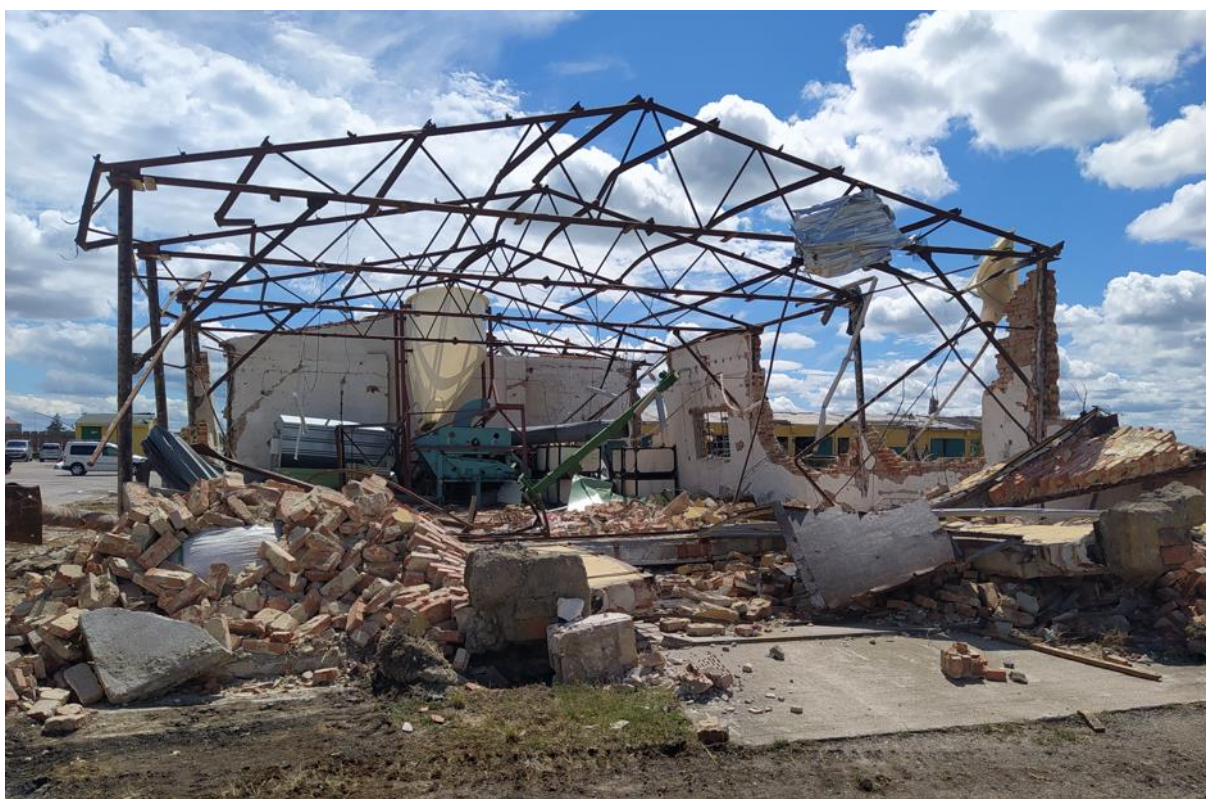
Obr. 40 Destrukce ocelové konstrukce kombinované s vyzdívkou z plných cihel
